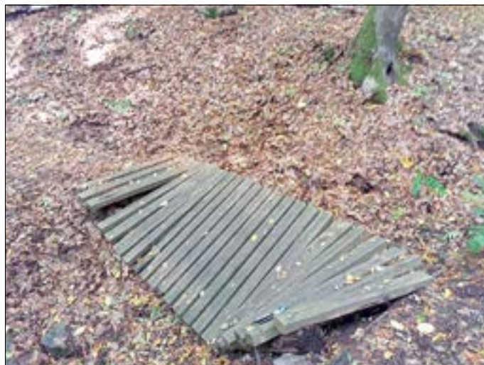
Kroatenschlucht - kaputte Fußgängerbrücke Foto: Dieter Kunze
